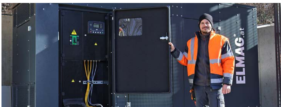
EVU-Mitarbeiter Gerhard Renner sorgt für eine ausfallsfreie Stromversorgung.
